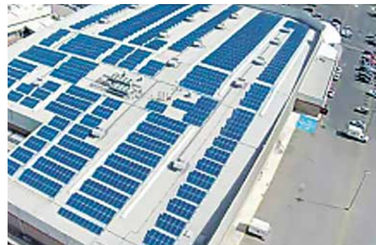
SISTEMA. A través de paneles solares, la empresa aprovecha los recursos.
